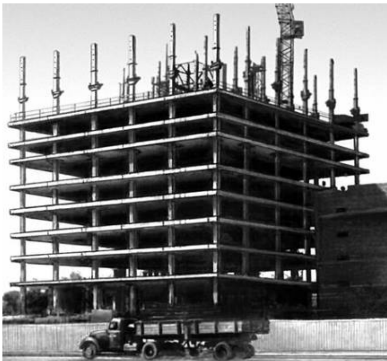
Рис. 6.1 – Будівництво 15-поверхової будівлі Центрального архіву в Москві методом підйому перекриттів (за допомогою електромеханічних підйомників, які встановлені «в обхват» колон, одночасно піднімають дві плити загальною масою 1100 т).
