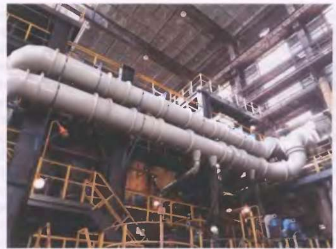
Рисунок 7.14 – Загальний вигляд установки хлорування
