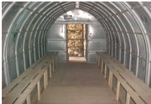
Рис. 2.46. Обладнання сховища для особового складу
