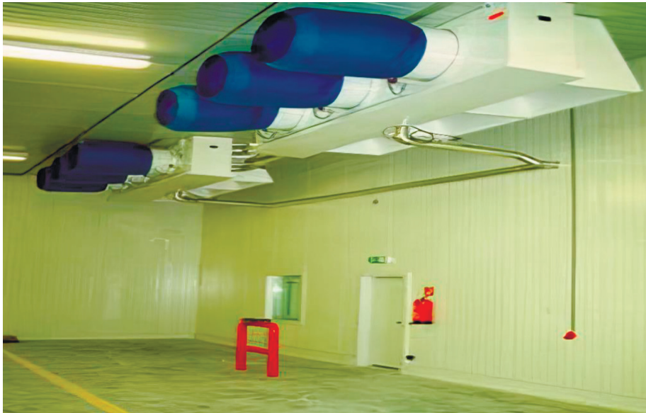
Рис. 2.6. Камера охолодження м'яса з сухими повітроохолоджувачами
