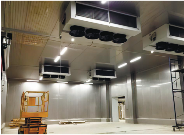
Рис. 2.11. Камера з підвісними повітроохолоджувачами
