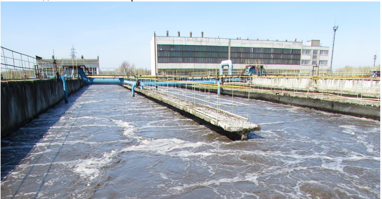
Рисунок 7.2 – Загальний вигляд аеротенку – на задньому плані компресорна станція, що подає до аеротенку стисле повітря для аерації стоків
