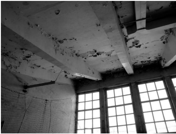
Рис. 2. Аварійний стан зали стадіону «Металург».
