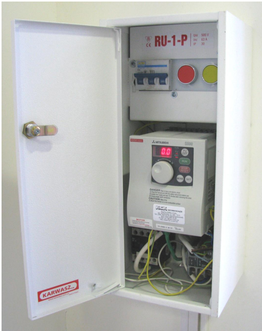
Рис. 3. Щиток з електрообладнанням для автоматичного керування рухом візка
