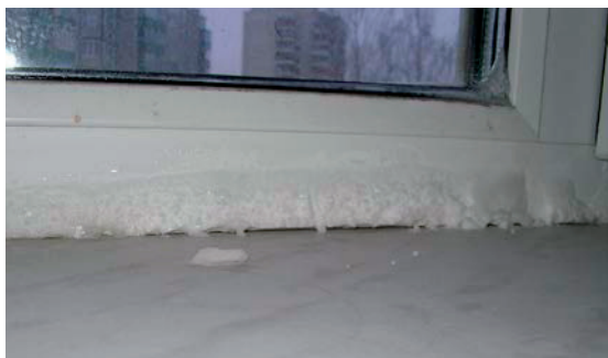
Рис. 4.39. Утворення льоду на підвіконні.
