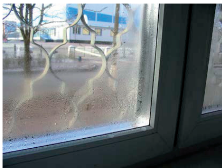
Рис. 4.37. Утворення конденсату на поверхні вікна.
