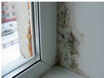
Рис. 4.38. Утворення плісняви на віконному відкосі.
