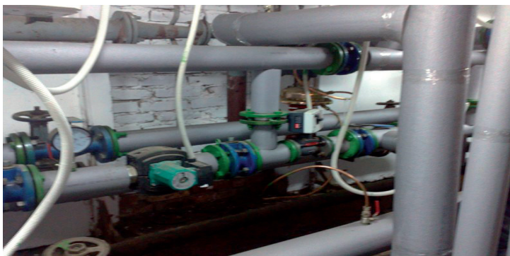
Рис. 6.10. Облаштування автоматизованого теплового пункту.
