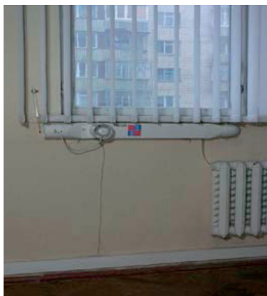
Рис. 4.43. Рекуператор встановлений під віконним пройомом.
