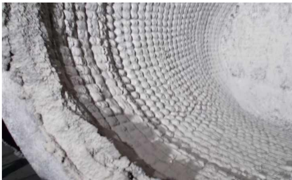
Рисунок 1 - Типовий знос робочої футеровки сталерозливного ковша
