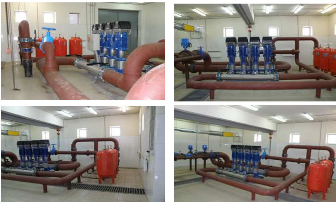
Рисунок 2.26 – Підвищувальна водопровідна насосна станція (м. Санкт-Петербург), 2008 р.
