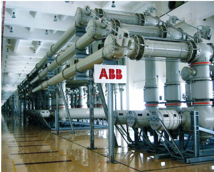
Рис. 4.127. Розподільний пристрій підстанції 550 кВ з елегазовою ізоляцією
