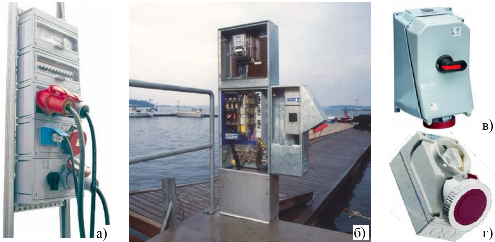
Рис. 4.61. Варіанти застосування промислових з'єднувачів: а – тимчасовий розподільний пристрій з приєднаними кабелями для живлення мобільного обладнання; б – розподільно-облікова шафа на пірсі яхт-клубу з додатковим щитком для тимчасового електроживлення яхт; в, г – живильні розетки з інтегрованими вимикачами
